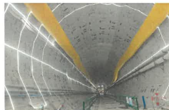
隧道已衬砌段灯带 参考图例1-6-12
