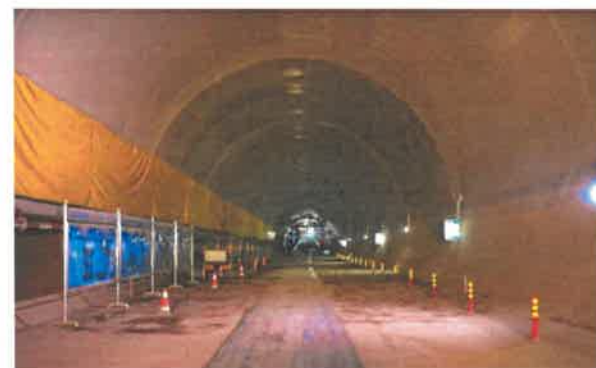
隧道供电 参考图例3-3-9
