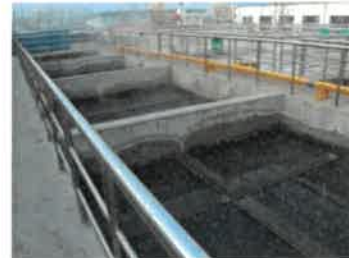
(f) 污水处理池
